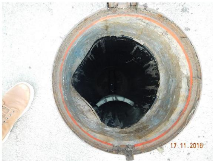
Slika 3: Prikaz deformiranog okna
