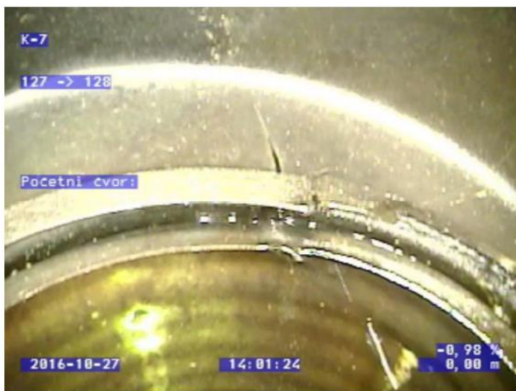
Slika 4: Prikaz pukotina i deformacija okna
