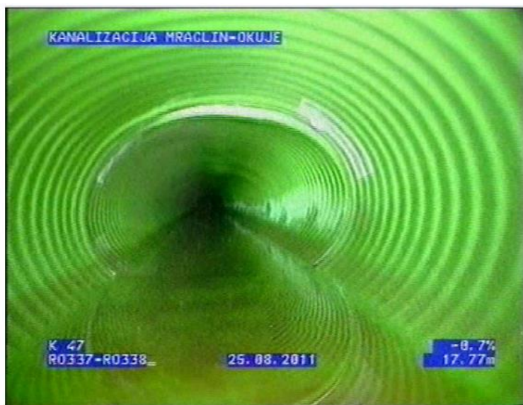
Slika 1: Prikaz vertikalne deformacije i napuknuća cijevi
